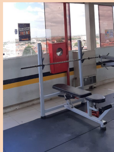
Foto 4 - Equipamiento de gimnasia en el suelo e hidrante fijo en la pared
